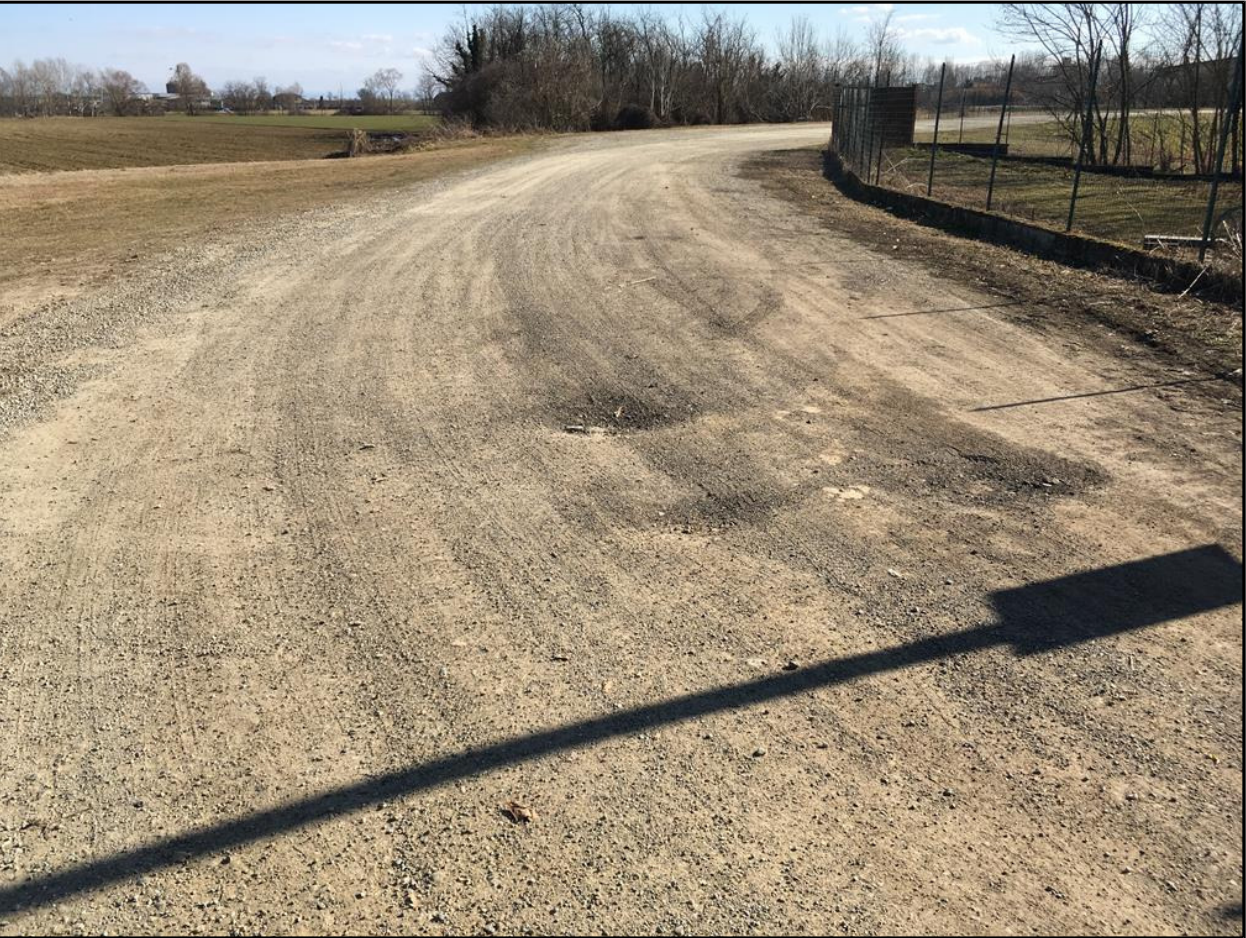
FOTOGRAFIA 2 - VIA E. RIVERA (strada bianca con buche e avvallamenti)
