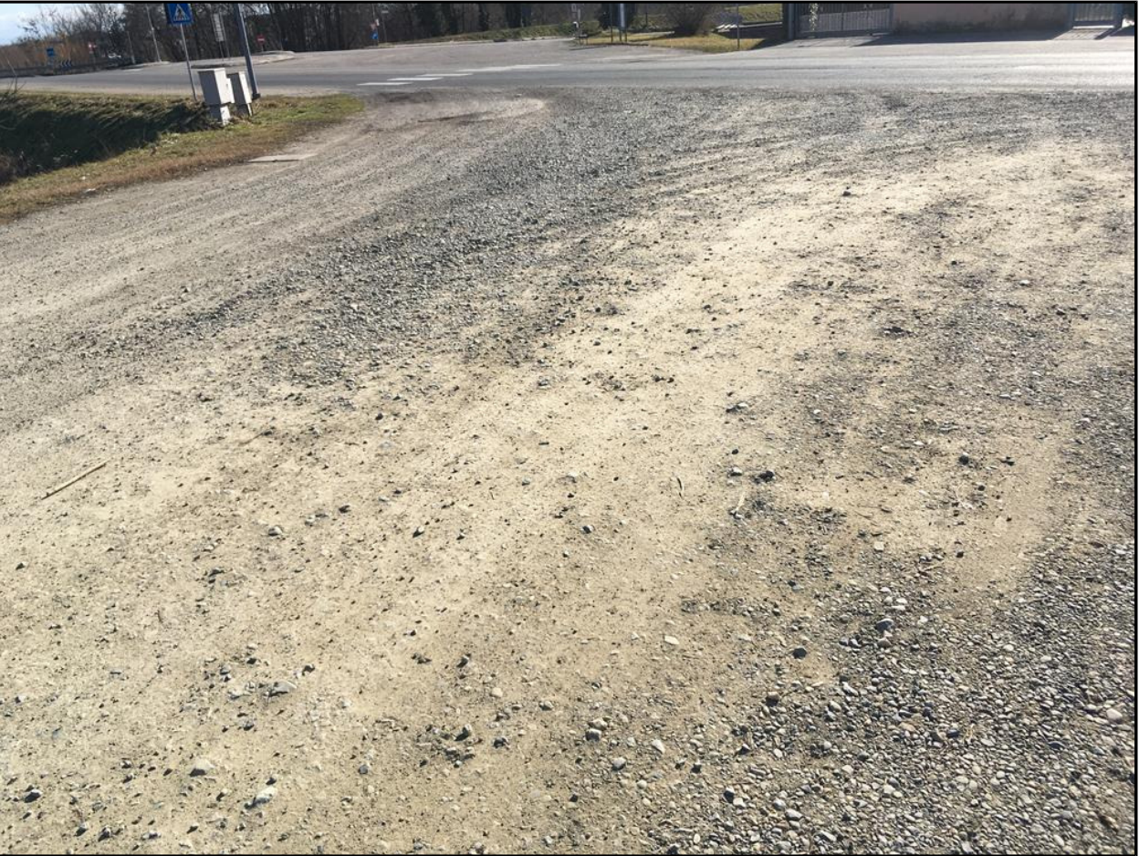
FOTOGRAFIA 6 - VIA E. RIVERA (strada bianca con buche e avvallamenti)
