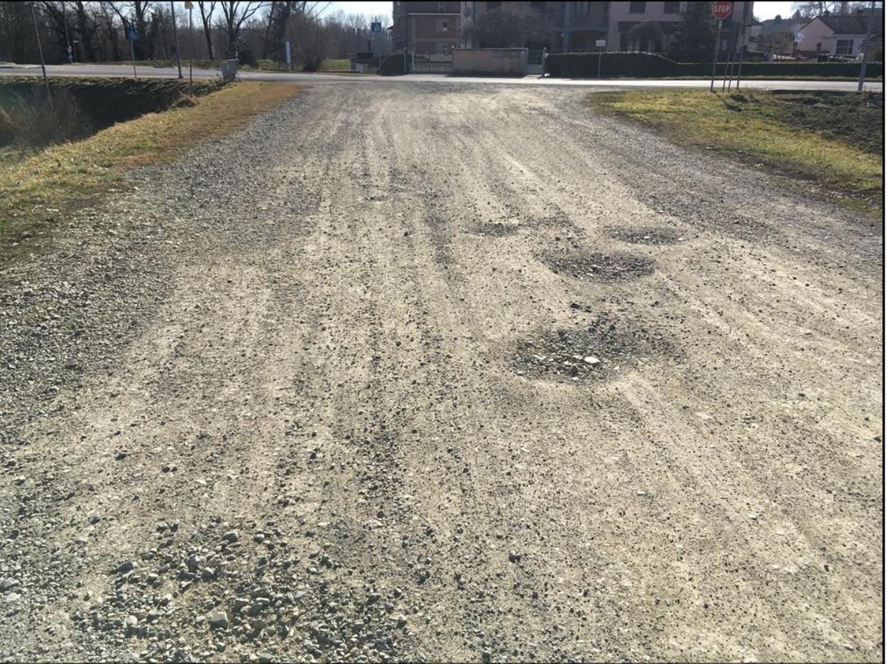
FOTOGRAFIA 5 - VIA E. RIVERA (strada bianca con buche e avvallamenti)
