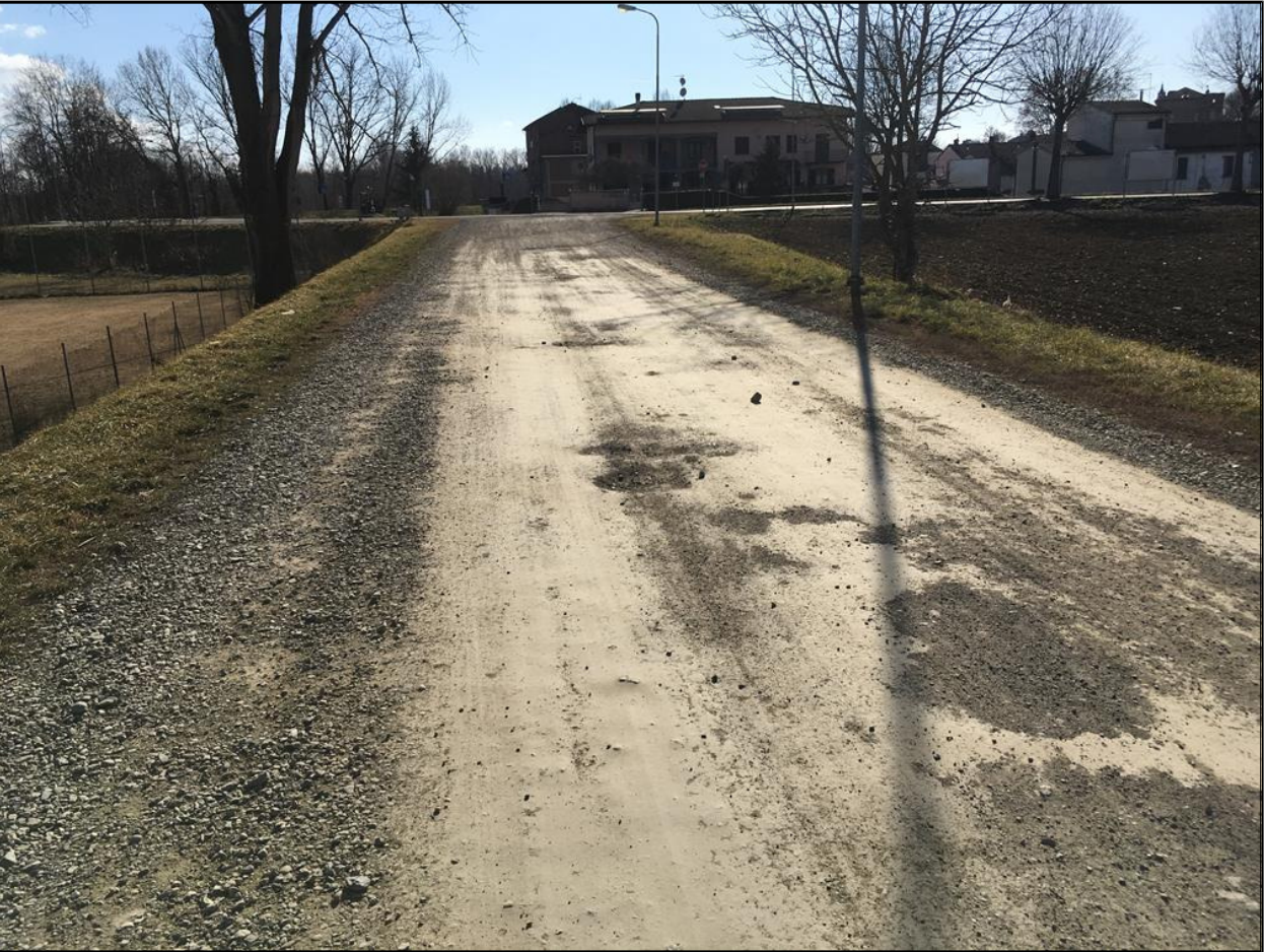
FOTOGRAFIA 4 - VIA E. RIVERA (strada bianca con buche e avvallamenti)
