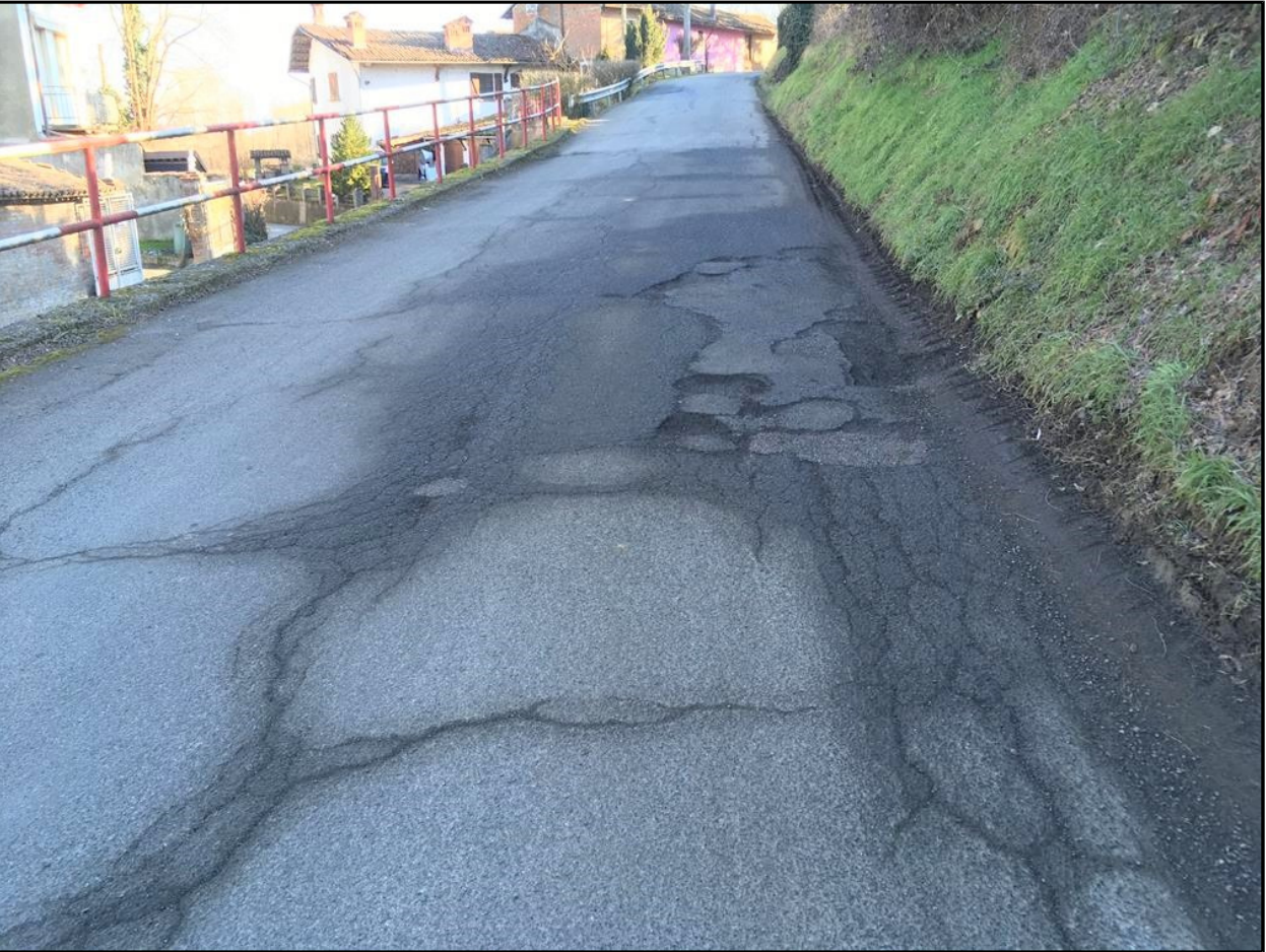
FOTOGRAFIA 8 - VIA G. MARCONI (particolare del cedimento con formazione avvallamento)
