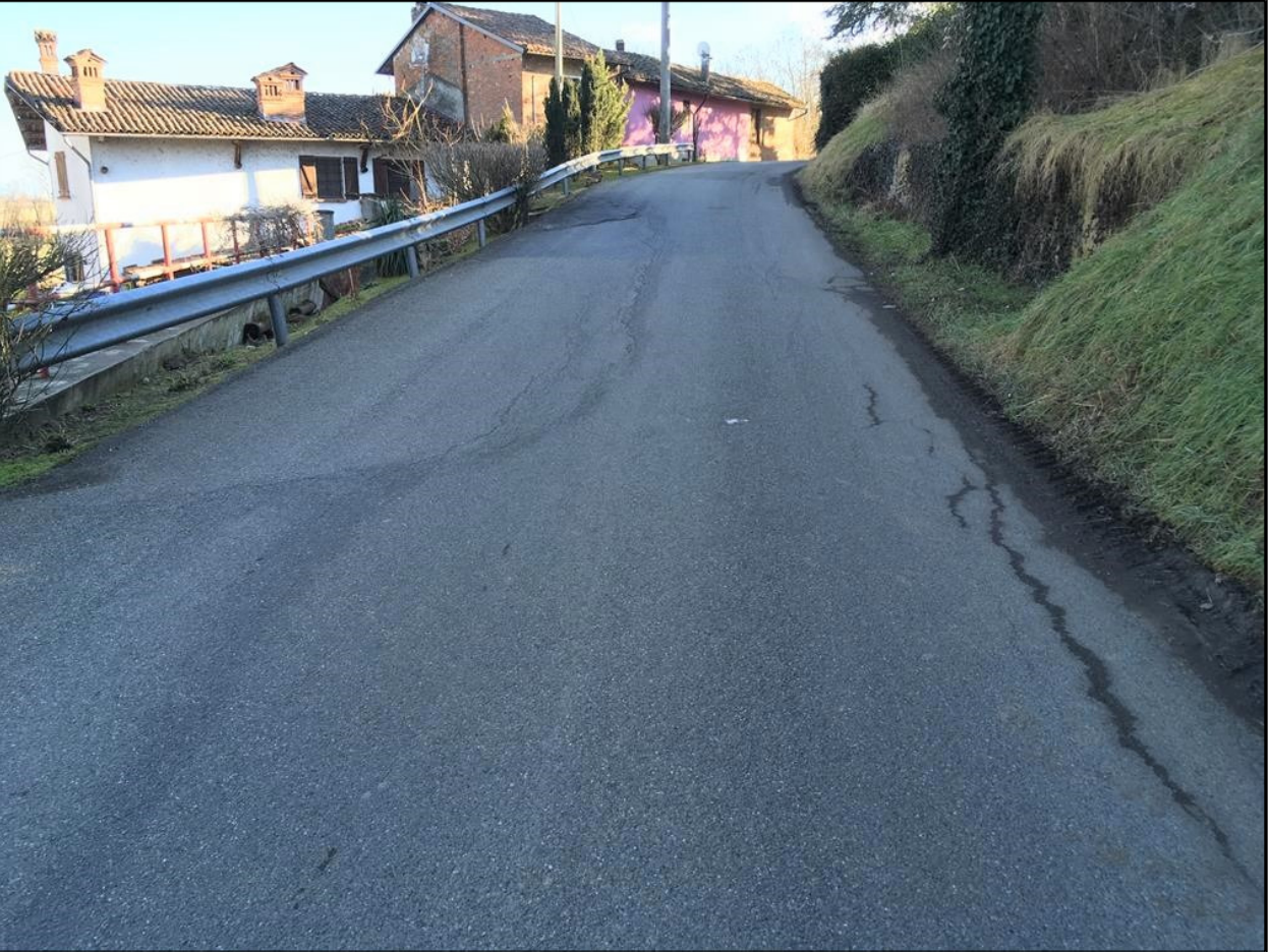
FOTOGRAFIA 7 - VIA G. MARCONI (particolare del cedimento con formazione avvallamento)
