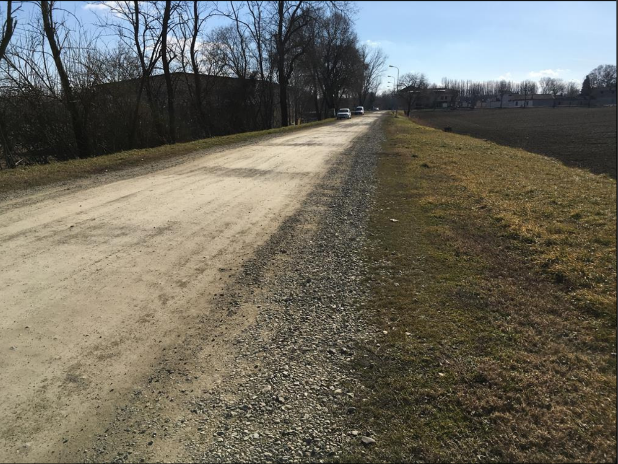
FOTOGRAFIA 3 - VIA E. RIVERA (strada bianca con buche e avvallamenti)
