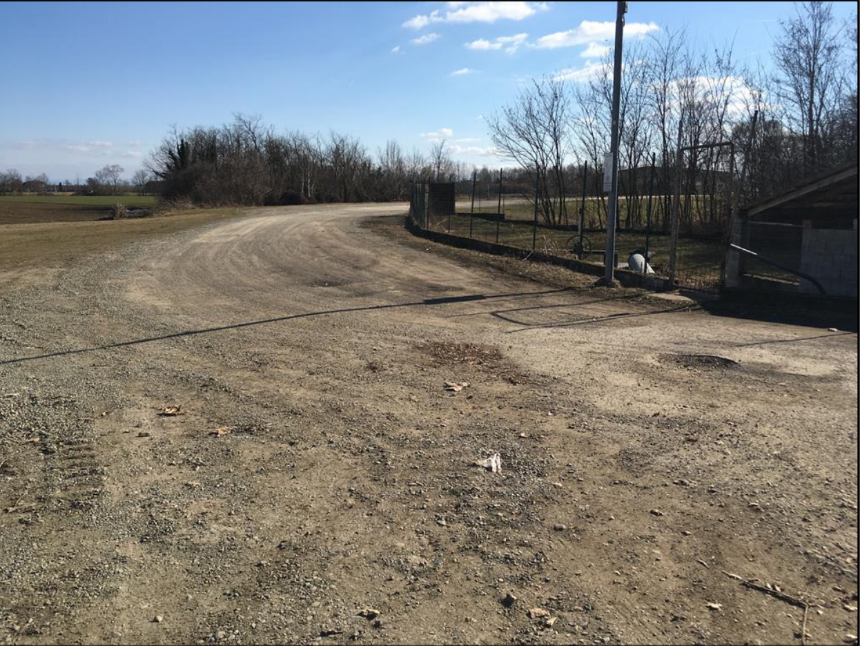
FOTOGRAFIA 1 - VIA E. RIVERA (strada bianca con buche e avvallamenti)
